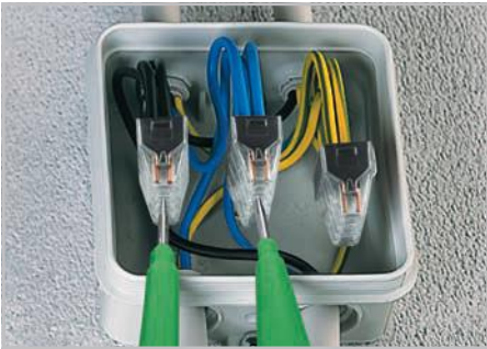
Измерение напряжения через отдельные тестовые гнезда.
