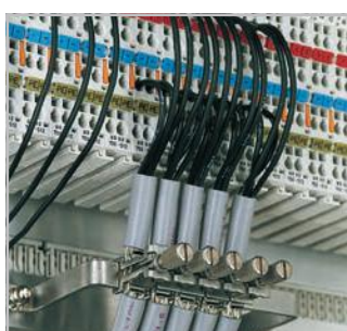
Установка на U-образной медной силовой шине
