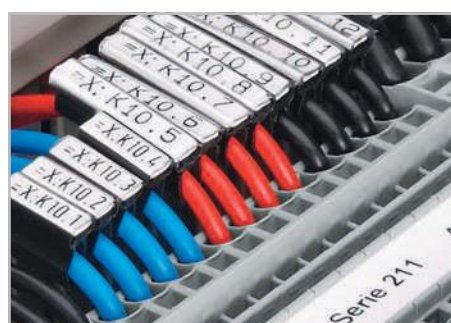
Маркировка проводников с помощью маркировочных манжет.
